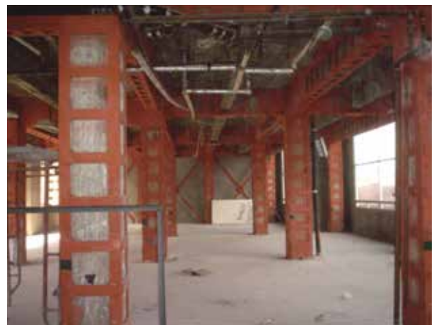
Figura 3. Fortalecimiento de columnas y traveses de un edificio antiguo, mediante el uso de ángulos y soleras de acero, para mejorar la capacidad de resistencia ante sismos.
